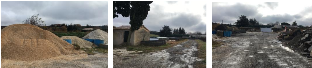
■ Vues sur les équipements et dépôts de matériaux existants sur la partie Est du site
